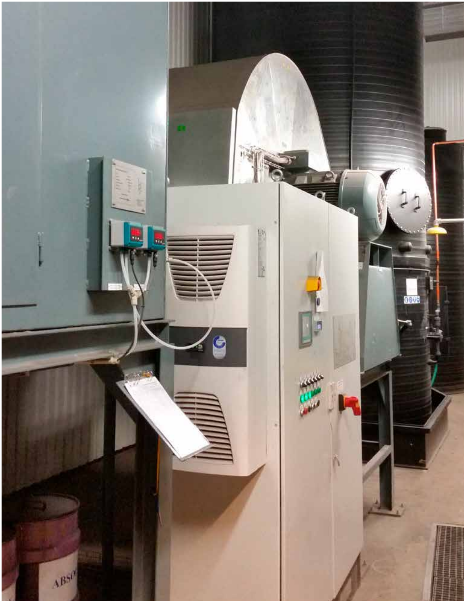
En skrubberanläggning har installerats på Arvika Gjuteri.
